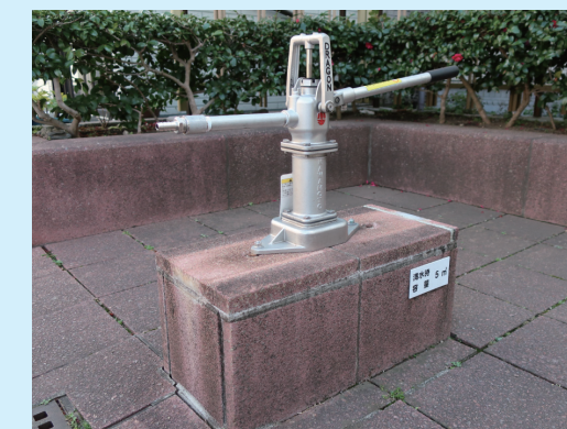
●新しくなったさくら一休の雨水ポンプ
