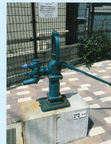
●タートルー休の雨水ポンプ
