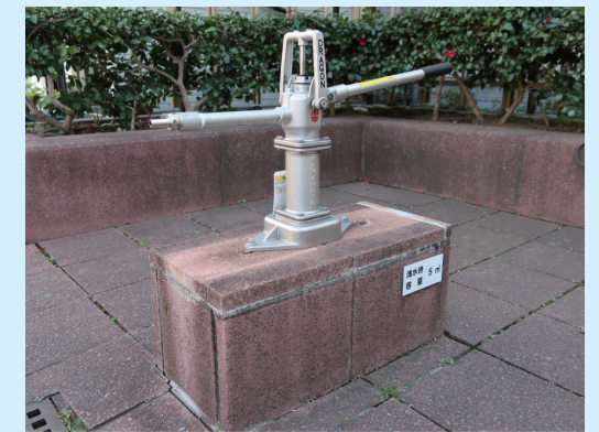
●新しくなったさくら一休の雨水ポンプ
